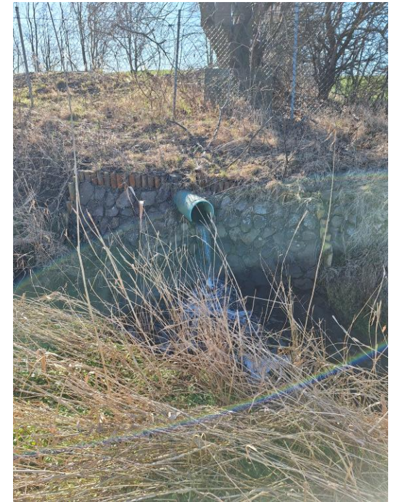
Einleitstelle bei ca. Station 1+008
