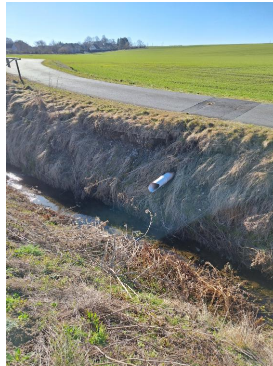
Einleitstelle bei ca. Station 1+163
