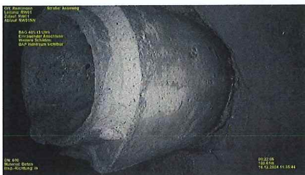
Foto 4: einragender Anschluß (Abflusshinderniss)
